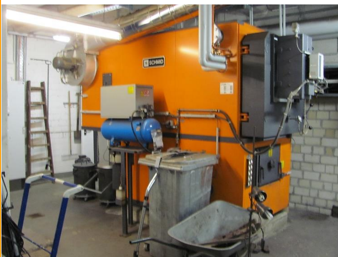
Heizzentrale Altenheim mit Hackschnitzelkessel
